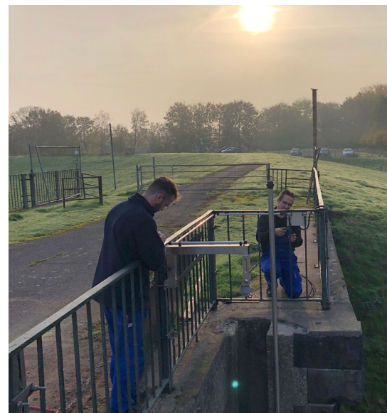
An der Ossenberger Schleuse in Rheinberg wurde ein neues Messgerät installiert
